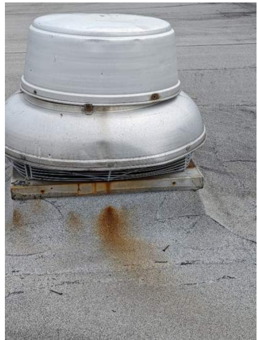
Photograph 64: Exhaust Fan Unit
